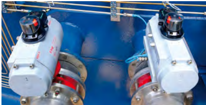
Zwei induktive Doppelsensoren der Serie F31K2 im Einsatz auf pneumatischen Antrieben für die Ventilstellungsrückmeldung bei Frisia Zout in Harlingen, Niederlande.
