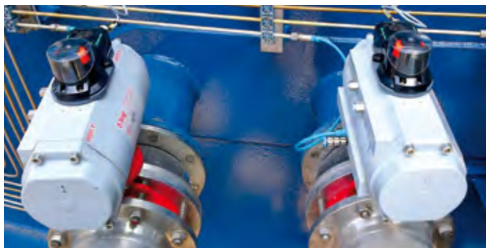
Twee dubbele inductieve F31K2-sensoren gemonteerd op pneumatische actuatoren bij Frisia Zout in Harlingen.
