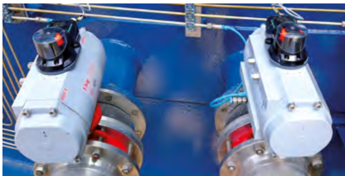
Podwójne czujniki indukcyjne F31K2 zamontowane na pneumatycznych siłownikach zaworów w zakładzie Frisia Zout w Harlingen w Holandii.
